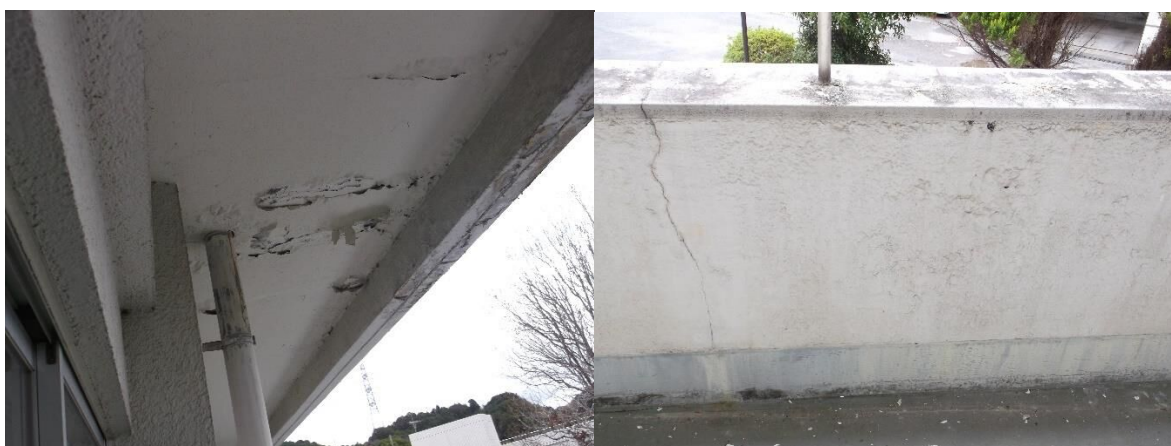
(監査人撮影:雨漏りや老朽化の状況)
