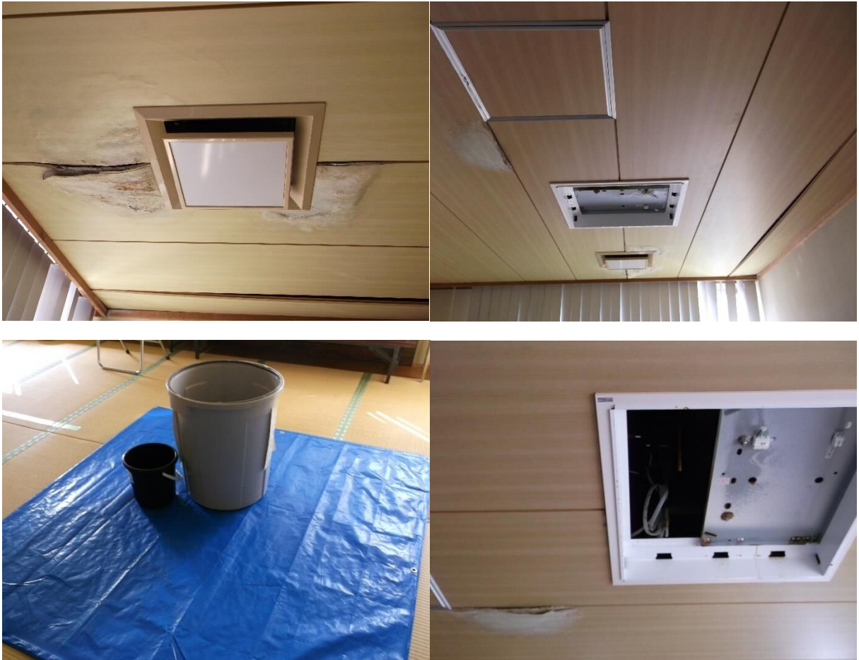
(雨漏りの状況について、監査人撮影)
