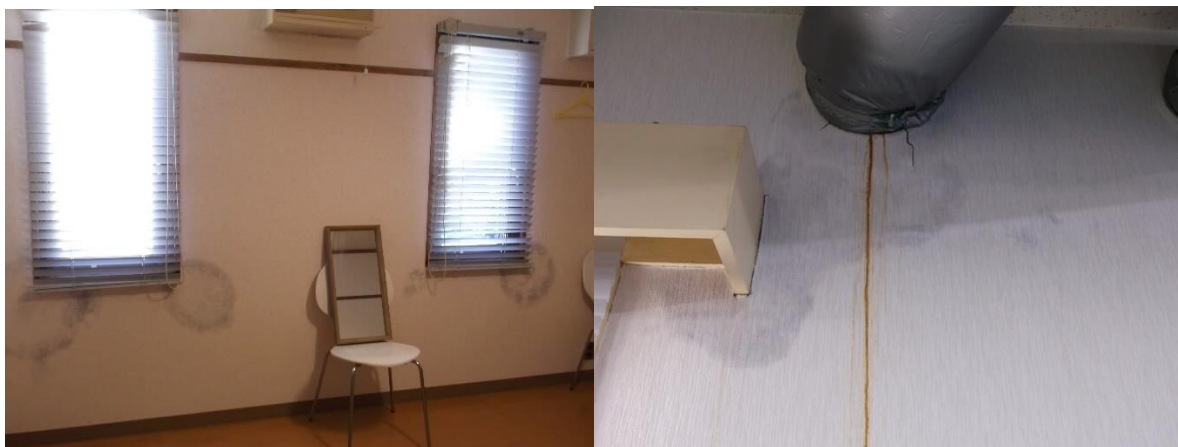
(監査人撮影:雨漏りや老朽化の状況)
