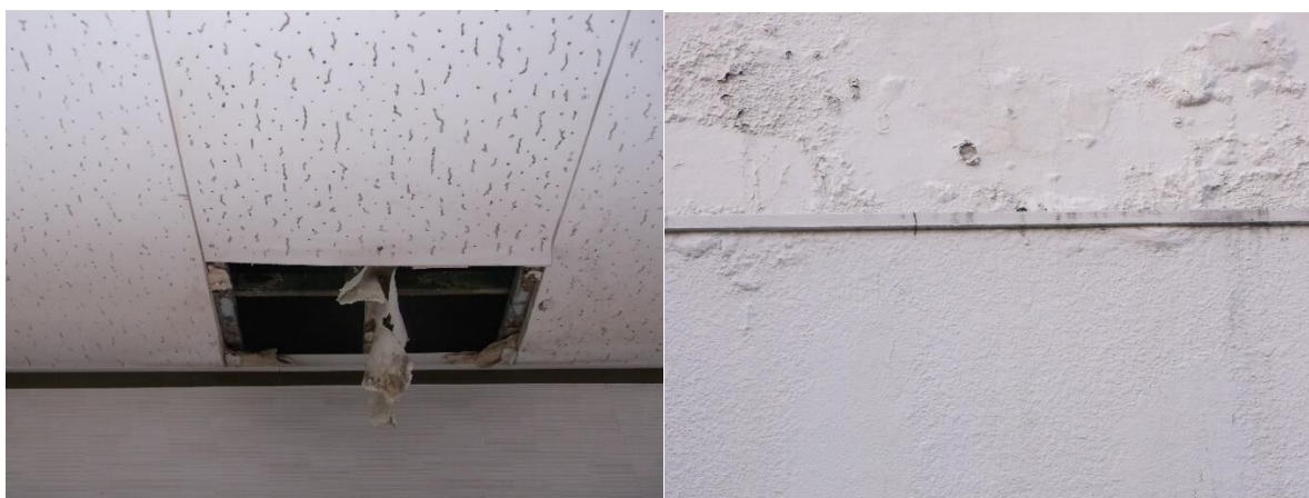
(監査人撮影:雨漏りや老朽化の状況)
