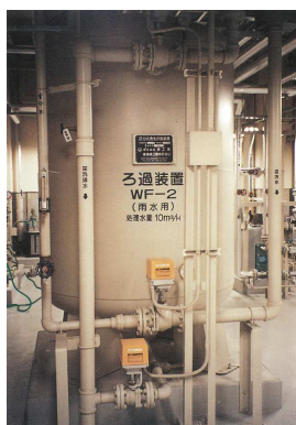
(1階に設置しているろ過装置)
