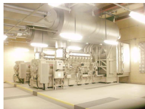
非常用 ディーゼル発電機
