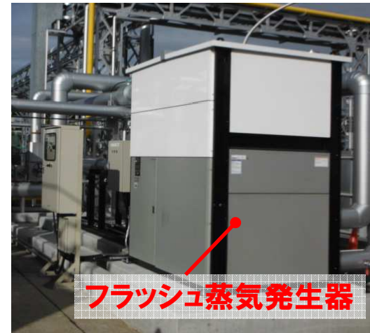
廃温水蒸気発生装置
