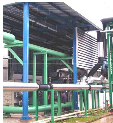
蒸気吸収冷凍機
