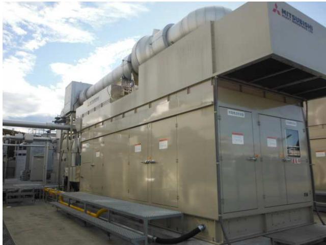
ガスエンジン発電設備 GS16R2-PTK / 1500kW
