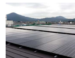
太陽光発電設備
