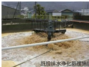
既設排水浄化処理施設
