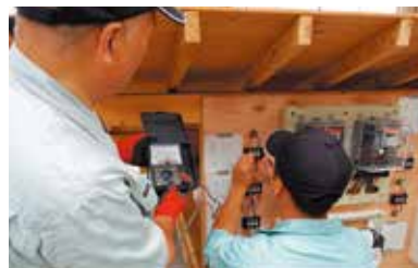
電気メーターの検査実習
