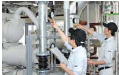
空調設備運転実習
