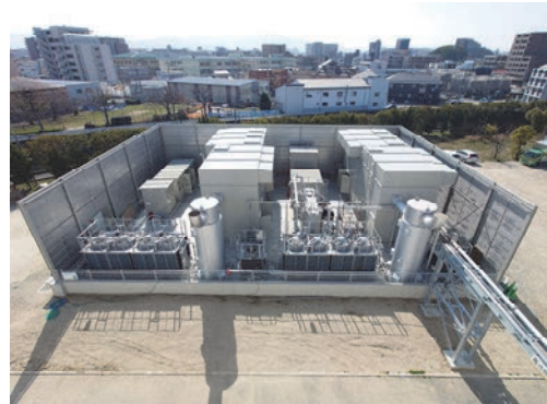
消化ガス発電施設の全景写真
