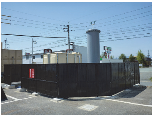
可燃性天然ガス分離設備等の様子
