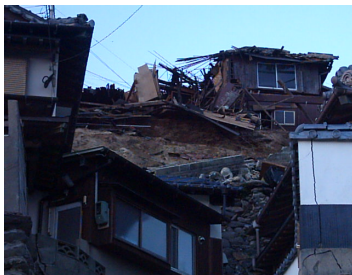
【玄界島の被害状況】
