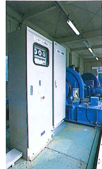
ゲート操作盤
